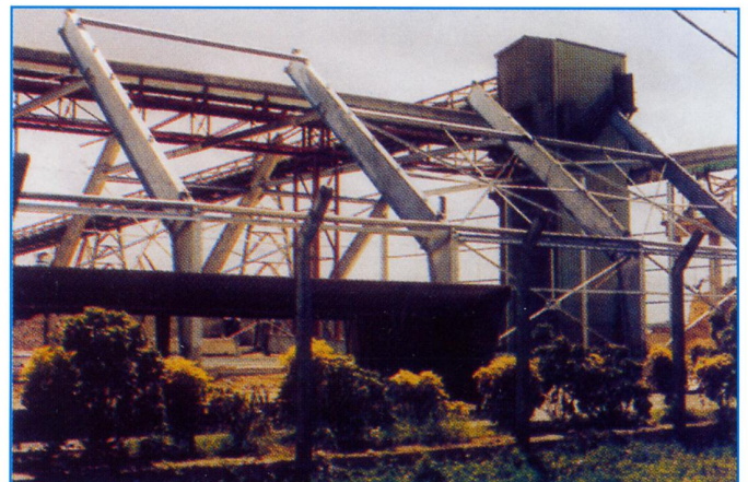
SILOS DE STOCKAGE CIMENTS ANTILLAIS
